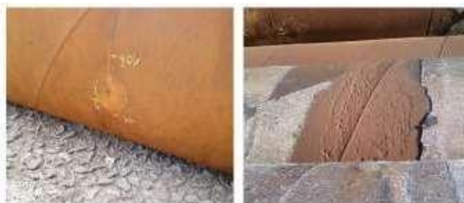
Figure II.1. Corrosion d'un pipeline en API X60 de diamètre de 1016mm et épaisseur de 12.7mm [16]
