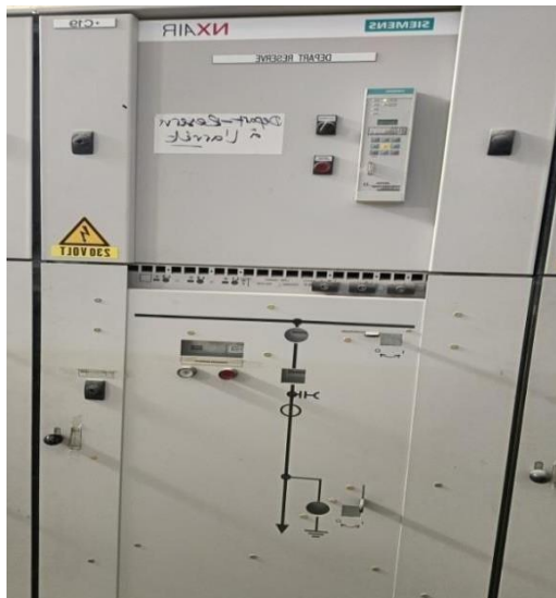
Figure I. 3 : Vue de la cellule de réserve du poste HT
