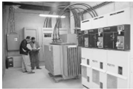
Figure II.4 : Poste de type intérieur HT/BT en réseau 20 kV [3]
