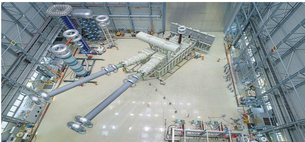
Figure 1-13: Transformateur de conversion
