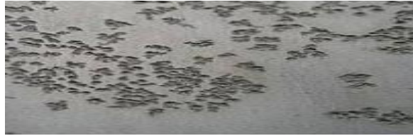
Figure 2 : Corrosion par piqûre
