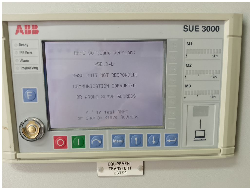
Fig. III.13 : Message d'erreur de communication affiché sur l'interface RHMI du système HSTS2 (ABB SUE 3000)
