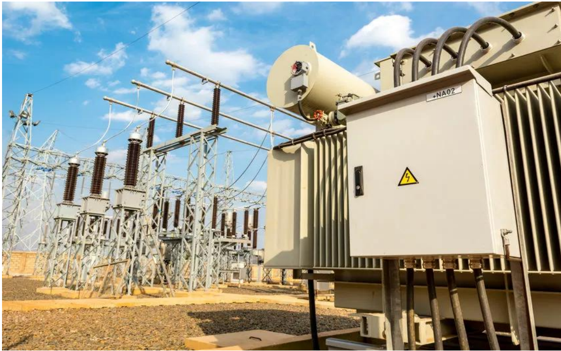
Figure I. 2 le poste de transformation [12]
