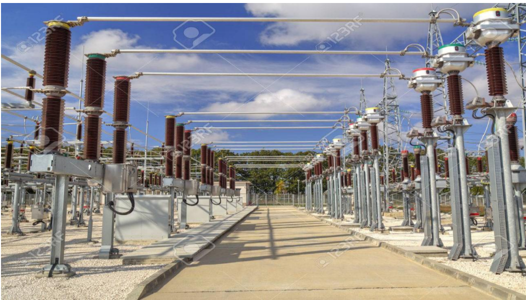
Figure I. 1 le poste d'interconnexion [11]
