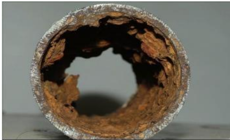
Figure 1-1 : Phénomène de la corrosion dans les pipelines.
