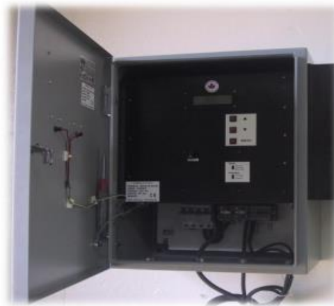
Figure 3-7 : Transfo Redresseur Auto Potentiel 30V/40 A (Type)
