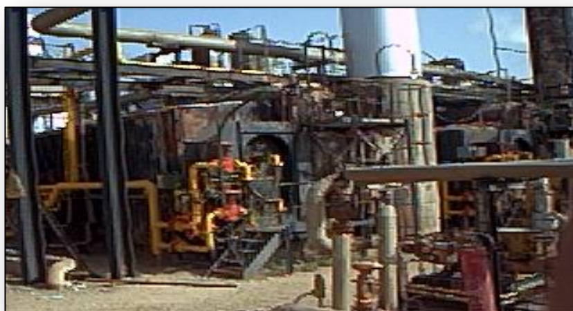
Figure I.6: chaudière de vapeur
