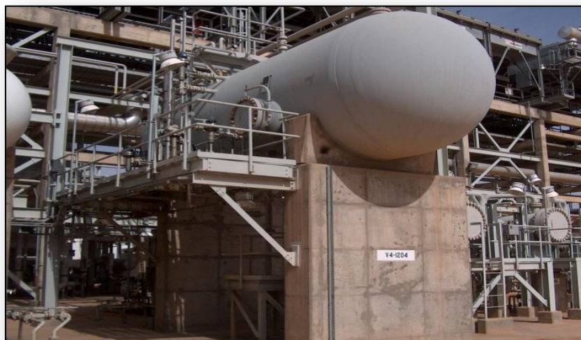
Figure I.3: ballon de séparation.
