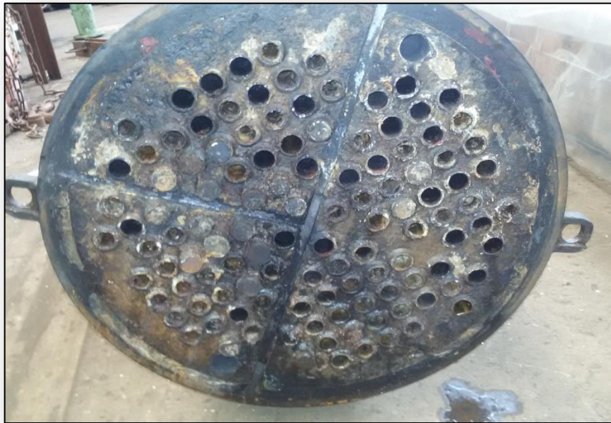
Figure V.1 : l'encrassement au niveau de la plaque tubulaire
