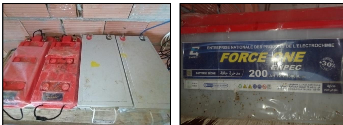
Figure IV.13: Les batteries de l'installation (4 batteries en série de 12V)
