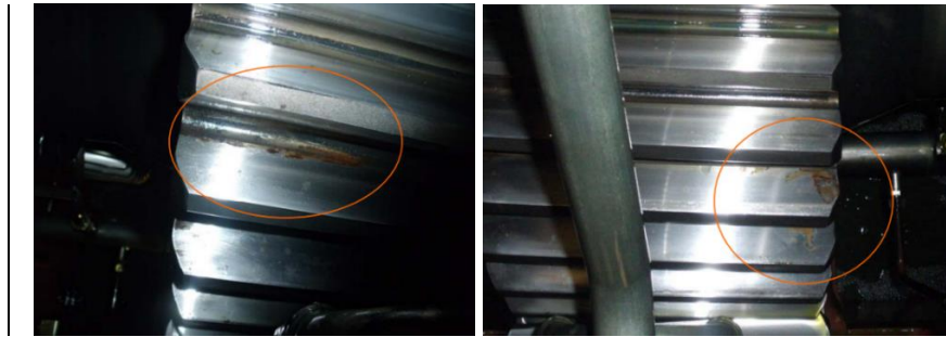
Fig 15. Formation de rouille sur pignon.
