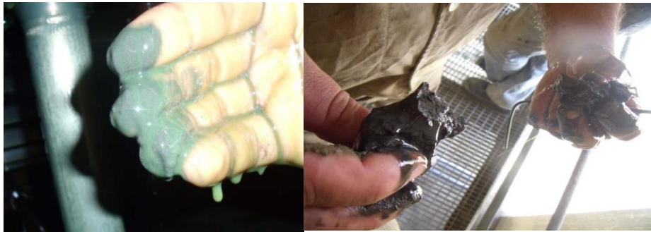
Fig 16. Huile contaminé et ciment accumulé et solidifié au fond du bac du réducteur.
