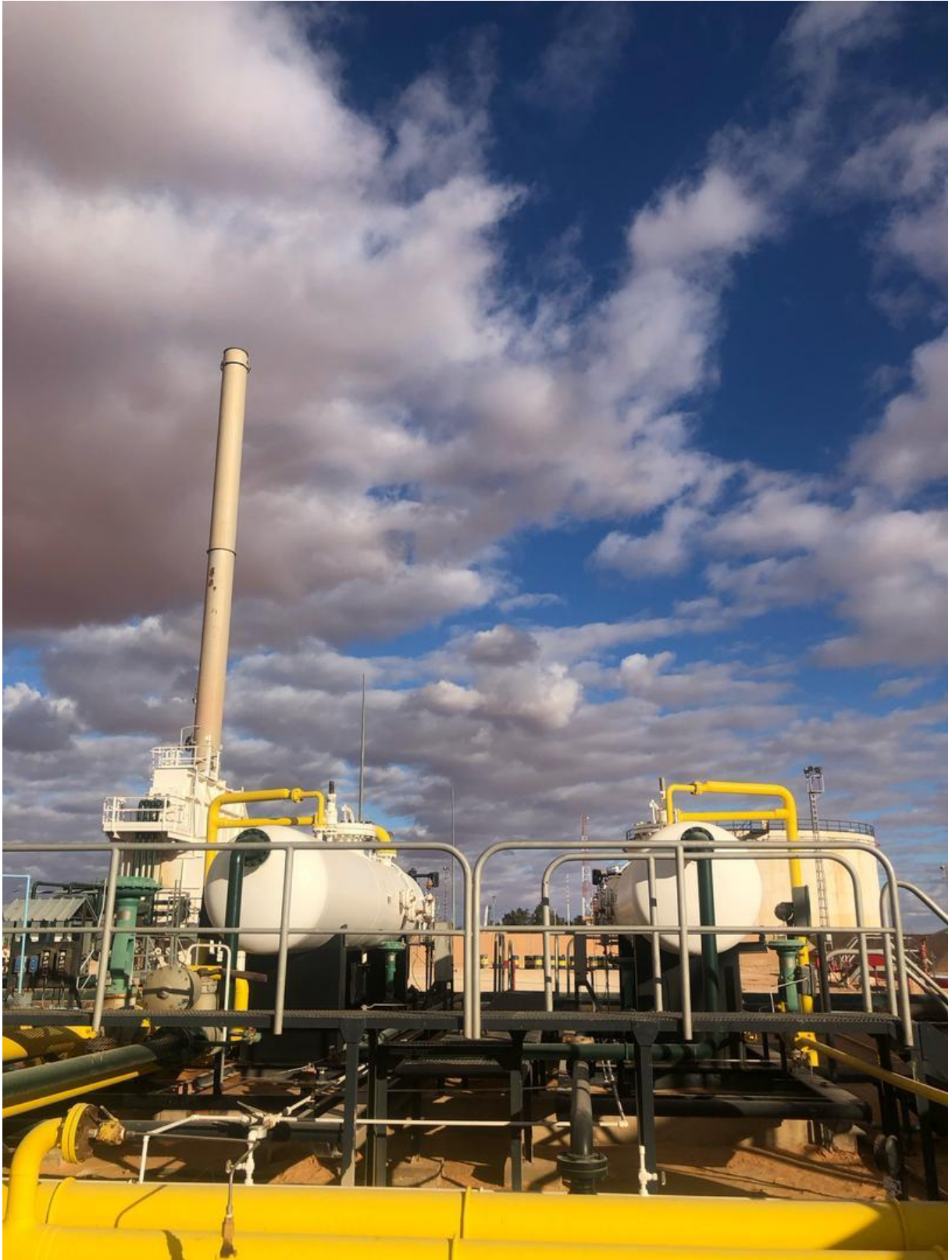
Figure 03 : Séparateurs V1503 et FWKO
