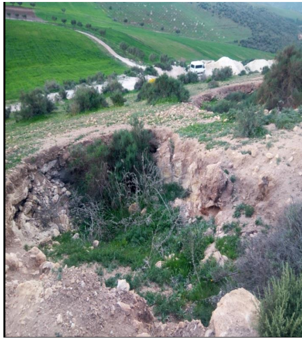
Figure III.9: Affaissement du toit
