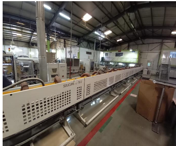
Figure 12 : Photo du tunnel de chauffage SOUCURE prise chez MMBox
