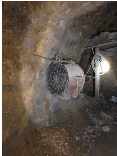
B : Secondary Ventilation Fan
